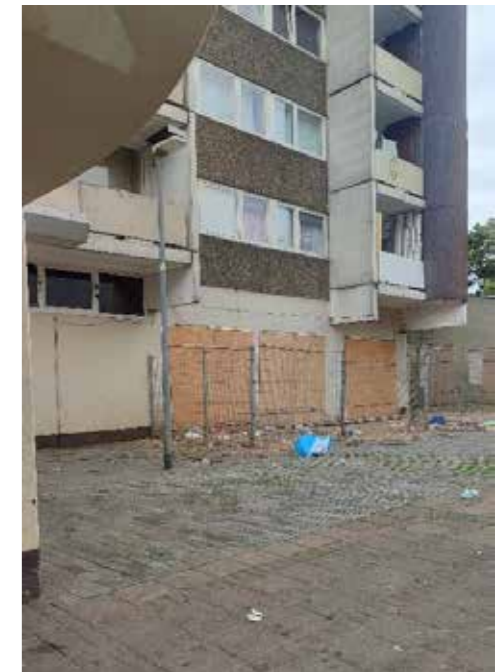
Abb.5.3: Vernagelte Sockelzone und Vermüllung. Originalaufnahme.
